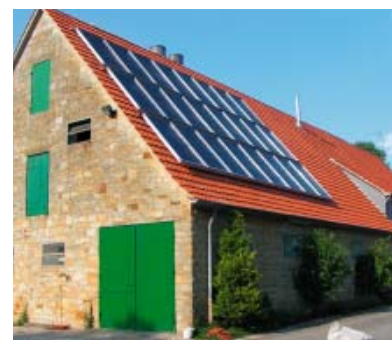
Landwirtschaftlicher Betrieb mit Aufdachmontage
